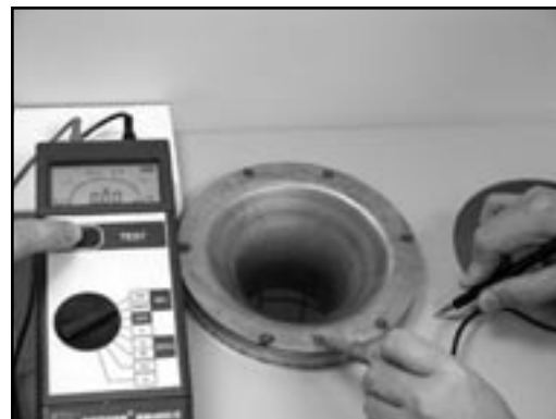
Colector de acceso superior: prueba de resistencia entre la jaula y el espejo.
